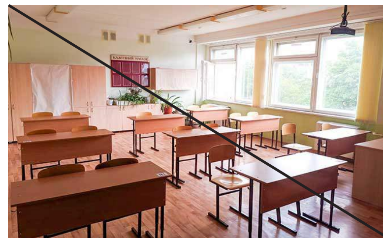
Плохо Линолеум под дерево
