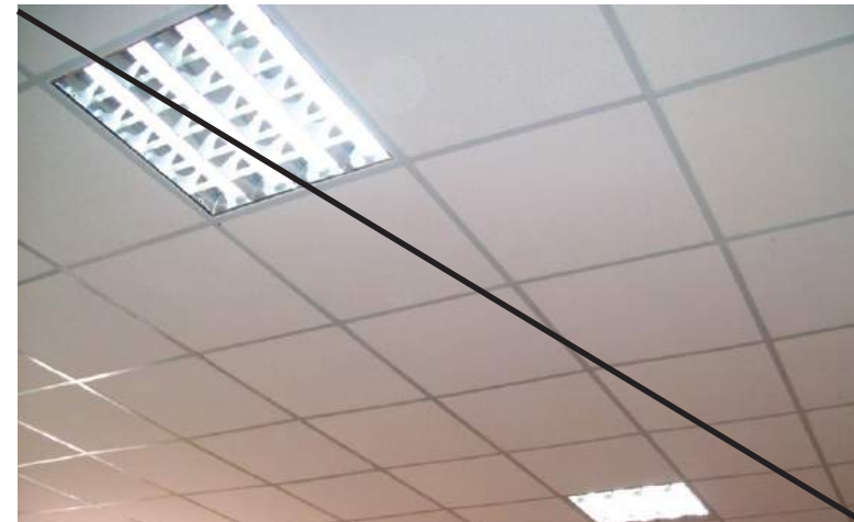
Плохо Открытые направляющие
